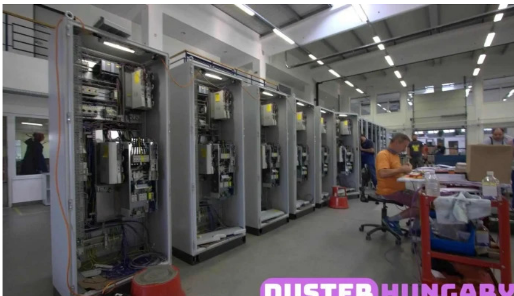
Kontakt elektro kft belül
