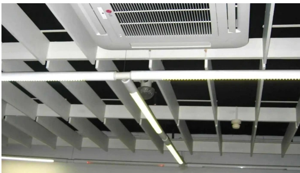
Korrekt kft hutestechnika legkondicionalas
